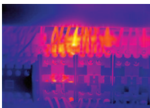
Своевременное обнаружение повышенного переходного сопротивления в клеммных соединениях
